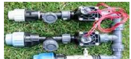
arrosage centralisé équipé d'un monitoring
