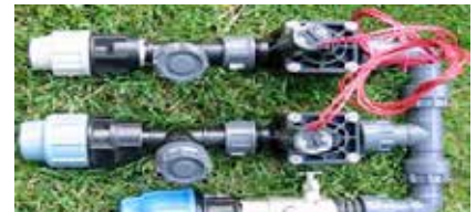
arrosage centralisé équipé d'un monitoring
